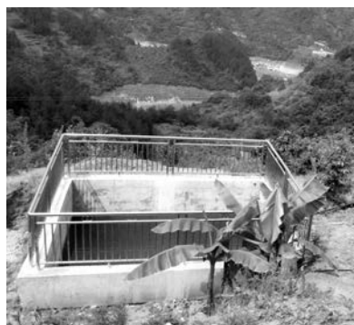
图3 支管蓄水减压池
